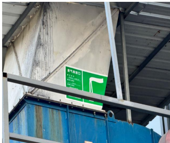
废气排气筒标识
