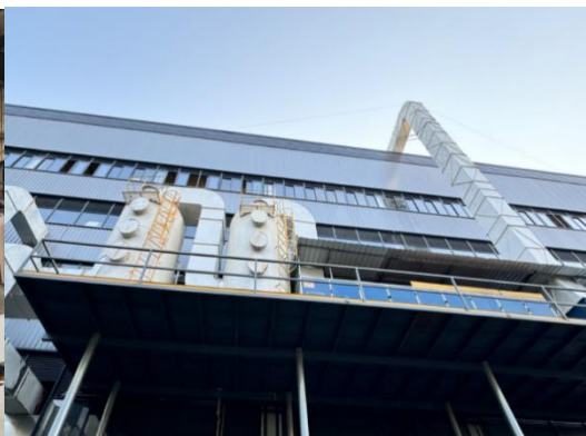
活性炭吸附脱附+催化燃烧装置
